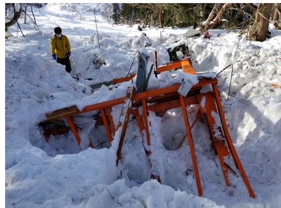
雪崩に巻き込まれた防災無線中継（令和 2 年度の豪雪）
