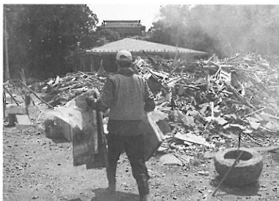
瓦礫の片付け
