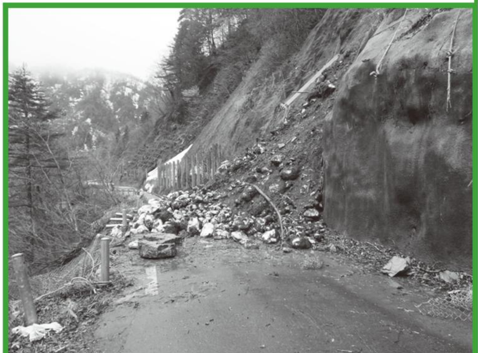
県道白山公園線の被害状況 ▶
